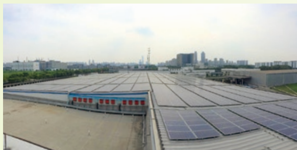
FUJIFILM Printing Plate(China) Co.,Ltd.に設置した太陽光発電設備
