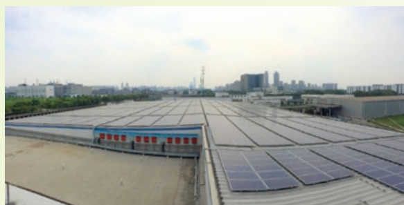
FUJIFILM Printing Plate(China) Co.,Ltd.に設置した太陽光発電設備
