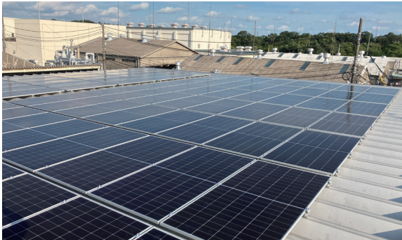
太陽光パネルの導入（東京工場）
